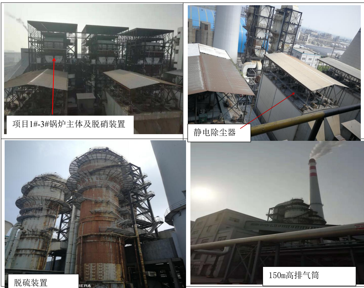
图3-1 废气处理设施及现场照片
